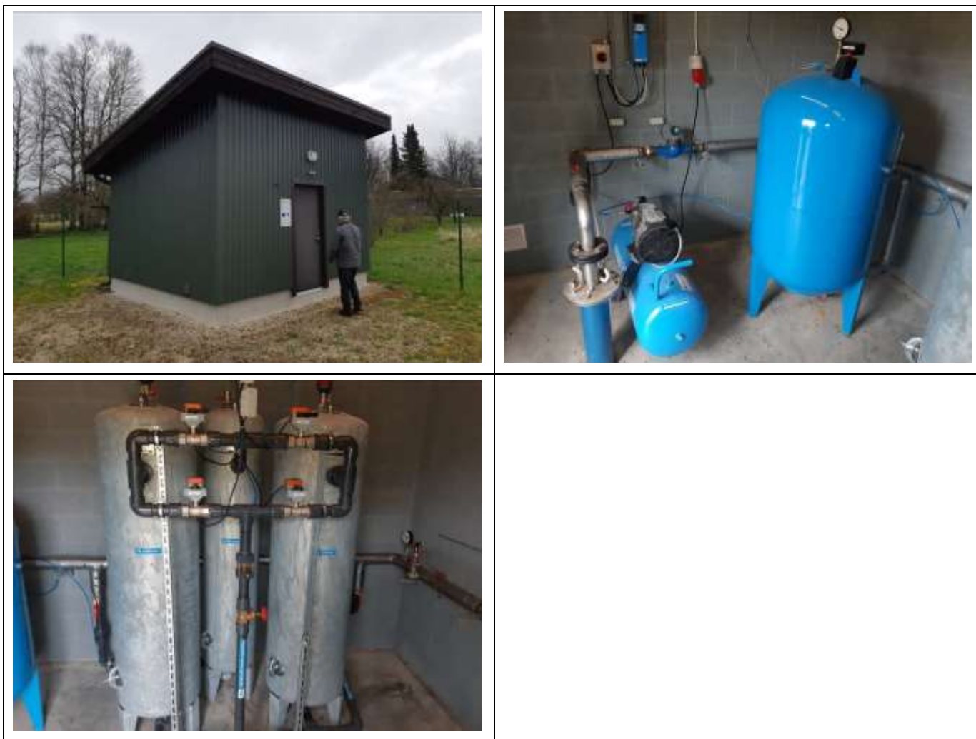
Joonis 24. Kõidama küla puurkaev-pumpla ja veetötlusjaam. Fotod: OÜ Alkranel 29.04.2020.
