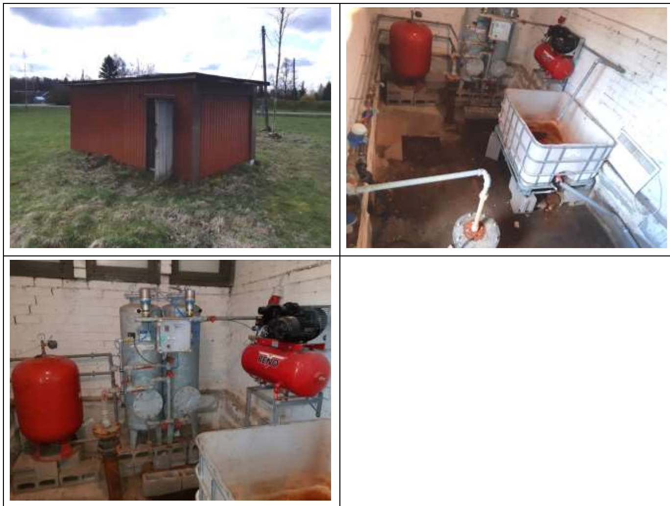
Joonis 20. Koksvere küla puurkaev-pumpla (katastri nr 6055) ja veetötlusjaam. Fotod: OÜ Alkranel 30.04.2020.
