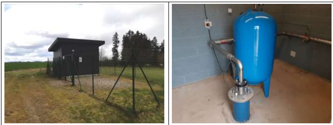
Joonis 26. Ülde küla puurkaev-pumpla (katastri nr 6081). Fotod: OÜ Alkranel 29.04.2020.
