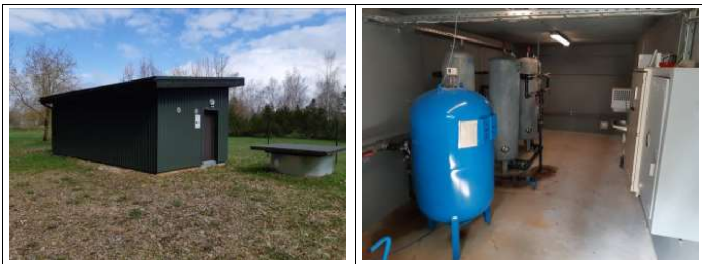
Joonis 22. Reegoldi küla puurkaev-pumpla ja veetöötlusjaam. Fotod: OÜ Alkranel 29.04.2020.
