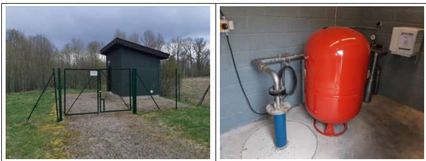
Joonis 27. Ülde Tiigi puurkaev-pumpla (katastri nr 51422). Fotod: OÜ Alkranel 29.04.2020.
