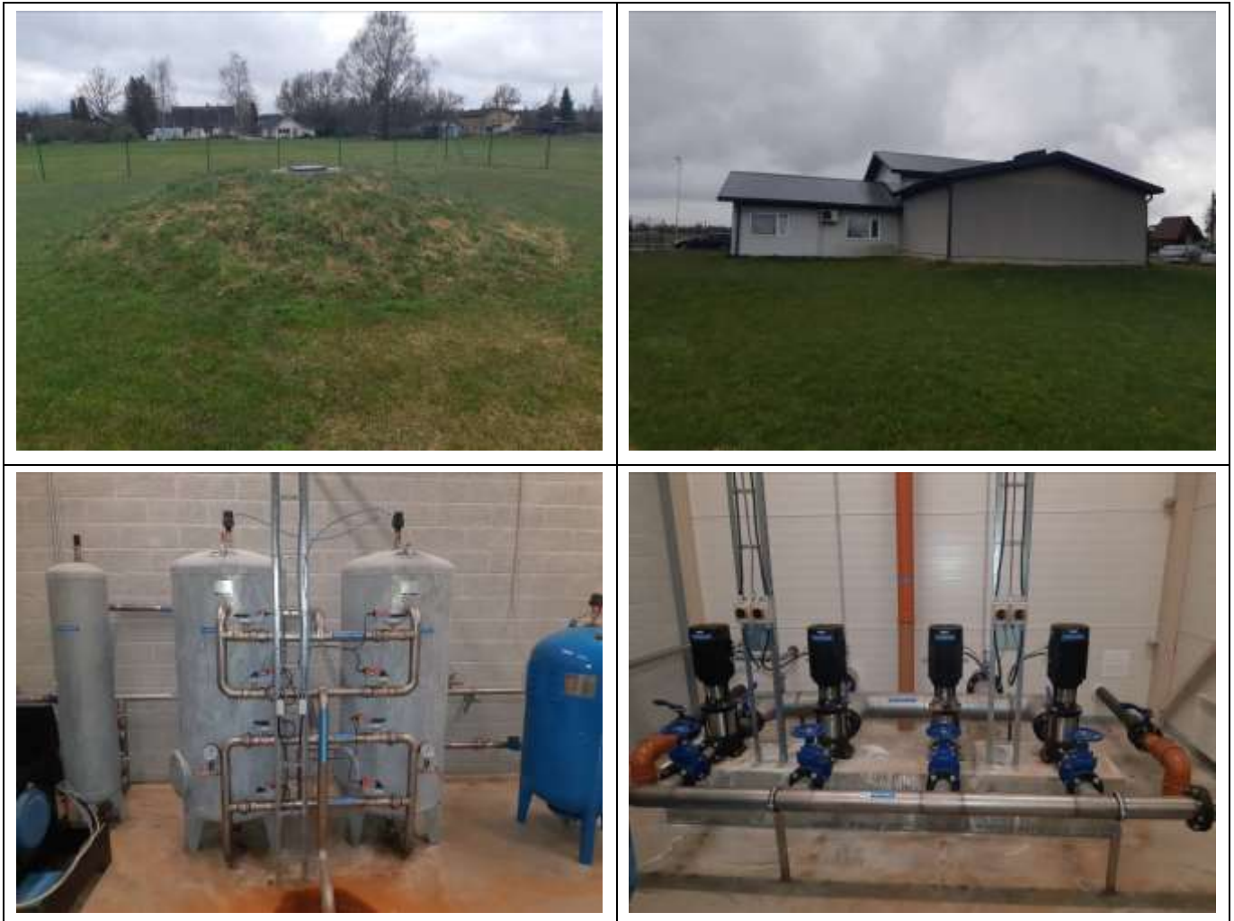
Joonis 3. Suure-Jaani linna Lauri puurkaev (katastri nr 51420) ning veetötlusjaam. Fotod: OÜ Alkranel 29.04.2020.
