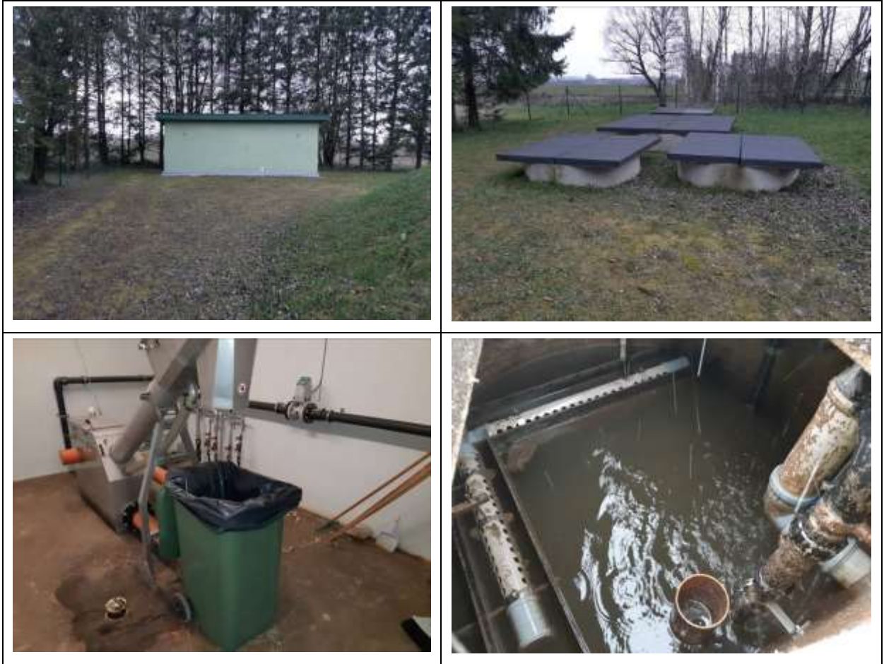
Joonis 17. Sürgavere küla reoveepuhasti. Fotod: OÜ Alkranel 29.04.2020.
