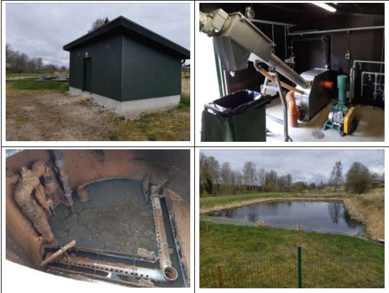
Joonis 23. Reegoldi küla reoveepuhasti. Fotod: OÜ Alkranel 29.04.2020.
