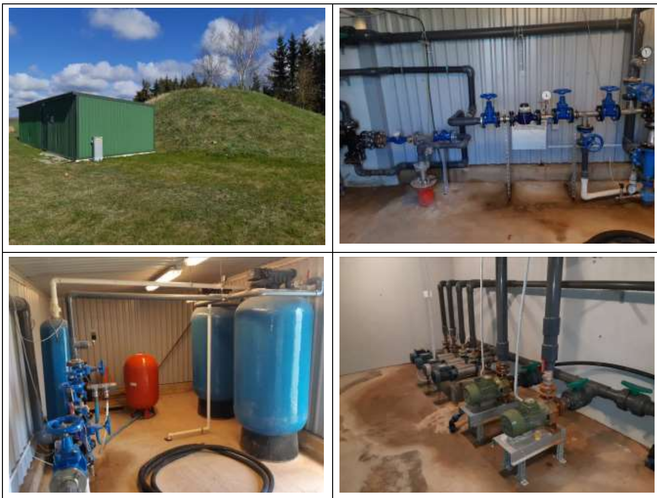
Joonis 6. Võhma linna Pargi tn uus puurkaev (katastri nr 23940) ning veetöötlusjaam. Fotod: OÜ Alkranel 30.04.2020.
